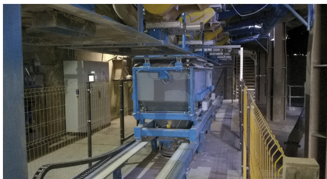
Linia technologiczna automatycznego naważania surowców
