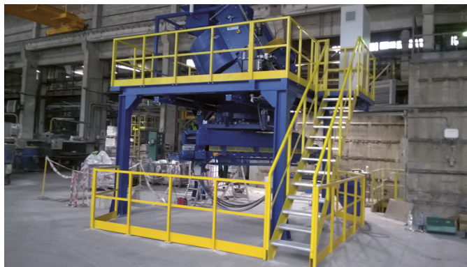
Linia technologiczna mieszania betonów
